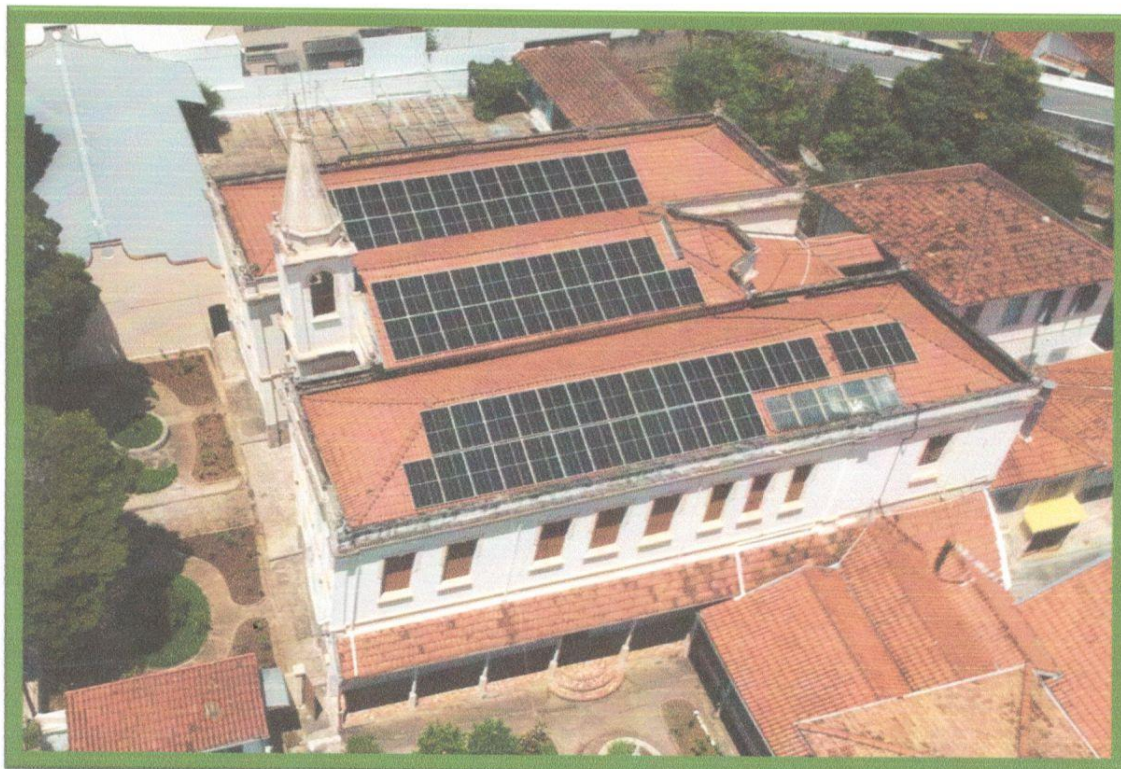
Vista Geral dos Painéis Instalados
