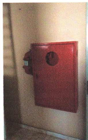
Hidrante piso superior CDHU
