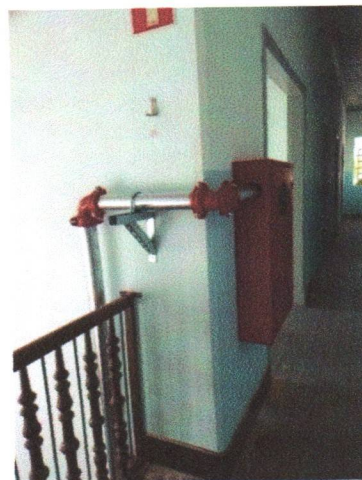
Hidrante piso superior Creche
